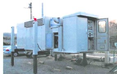
自揚型移動式発電装置 6,600V 500KVA
